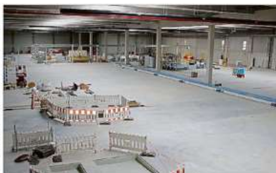
Aufbau läuft: In der Produktionshalle steht aktuell der Aufbau der zunächst drei Maschinenstraßen an.
